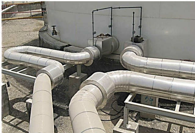
شکل ۱۵ اتصالات مارین لوپ نصب شده در بندرعباس
