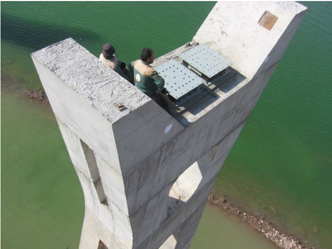
شکل ۱۲ جداگر و میراگر لرزه‌ای استفاده شده پروژه پل ریلی منجیل (قزوین- رشت)
